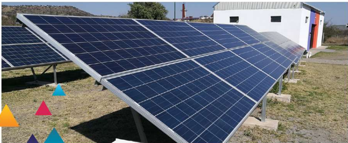
VISITA A PARQUE SOLAR FOTOVOLTAICO "TERRAZAS DEL PORTEZUELO" SAN LUIS
